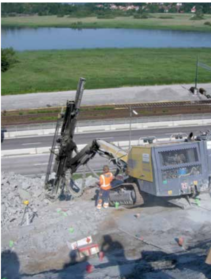
Förankring och fjärrstyrning samt utrymt nedanför.
