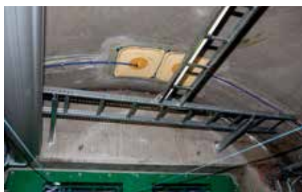
Den känsliga elektroniken i tvärtunnlarna måste skyddas från fukt. I taket syns hur man säkrar ett eventuellt läckage.
