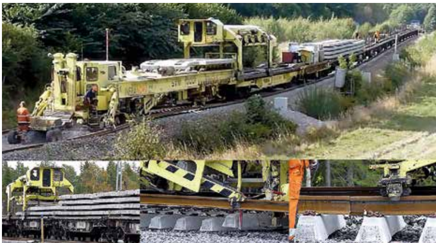
Kollaget visar hur spårläggningsmaskin SVM1000R arbetar. Järnvägsvagnarna i bakre delen kör på det spår som främre delen just lagt. De är lastade med sliprar som hela tiden matas fram av en kran som går på räls uppe på maskinen. Bilderna kommer från youtube-klipp, sök på SVM1000R och se videon från Haparandabanan.
