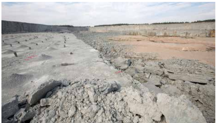
Cementas Västra brott där återställning pågår, ett flerårsprojekt. Med hjälp av lera blir tækten helt tät.
