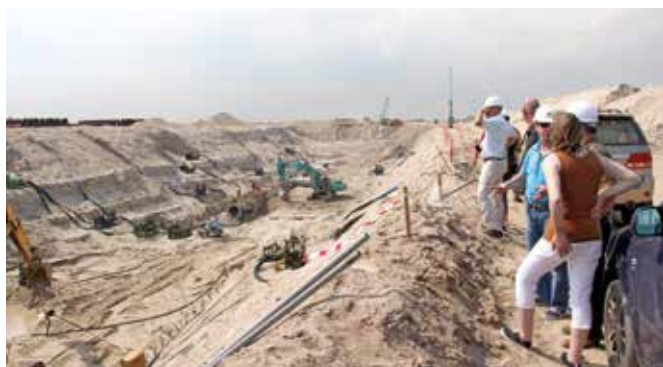
Tillfällig dränering håller grundvattnet borta när 2,2 km permanent dräneringen läggs. Land som utvinns ur havet är färdigt att tas i bruk efter 1 – 3 år. Vård för detta högtintressanta studiebesök var Van Oord.
