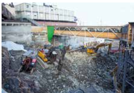
Området där man spränger. Gångtrafikanter får ta gångbron över till tunnelbanan och östra Slussenområdet. Foto: Anette Broman.
