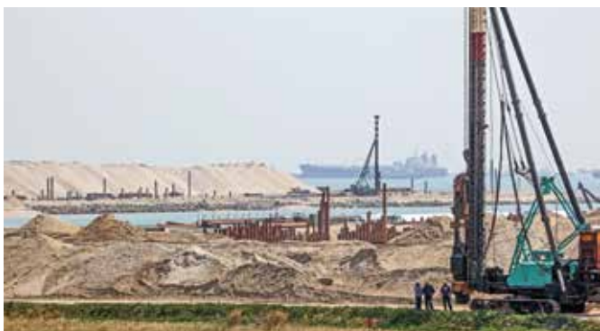
Sju öar ska länkas ihop med Jurang Island för att ur havet öka Singapores yta med 1 500 hektar, 230 milj. kubm sand har tillförts, 6 milj. kubm har muddrats och fyllts och 11 km kajkanter har lagts med spontrör och sandfyllda betongkasuner.
